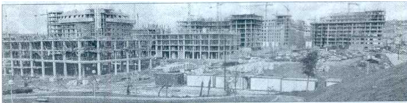
Vista panorámica de las obras de construcción de viviendas en Mina Miribilla, en Bilbao. / MIT
