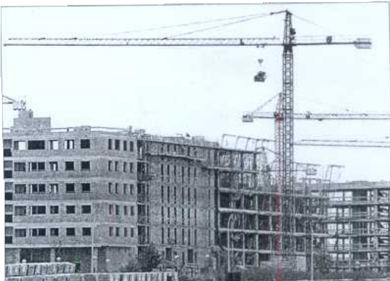
Construcción de nuevas viviendas en el barrio vitoriano de Lakua. / L. RICO
