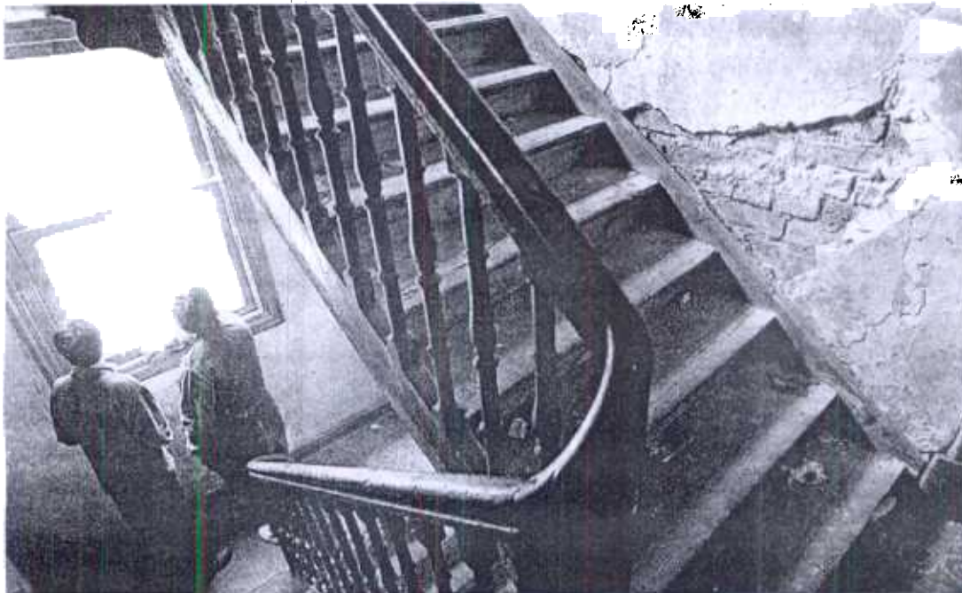
FUERTE DETERIORO. Dos vecinas conversan en el rellano de la escalera de un edificio de Bilbao La Vieja. / BERNARDO CORRAL
