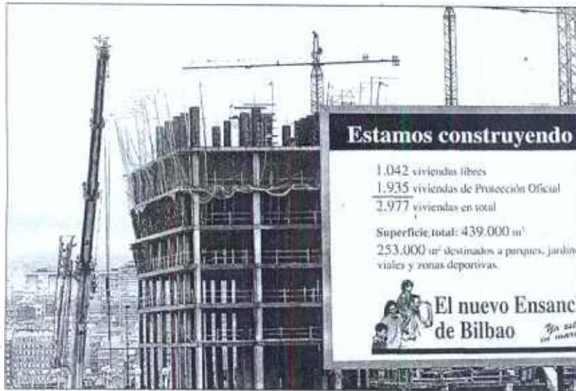
Un grupo de viviendas en periodo de construcción en la capital vizcaína. / CARLOS GARCIA
