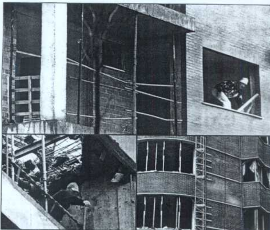
En la imagen de arriba, una construcción sin protección en ventanas y balcones. Abajo a la izquierda, un obrero lanza cascotes al vacío. A la derecha, una casa sin 'línea de vida'.
