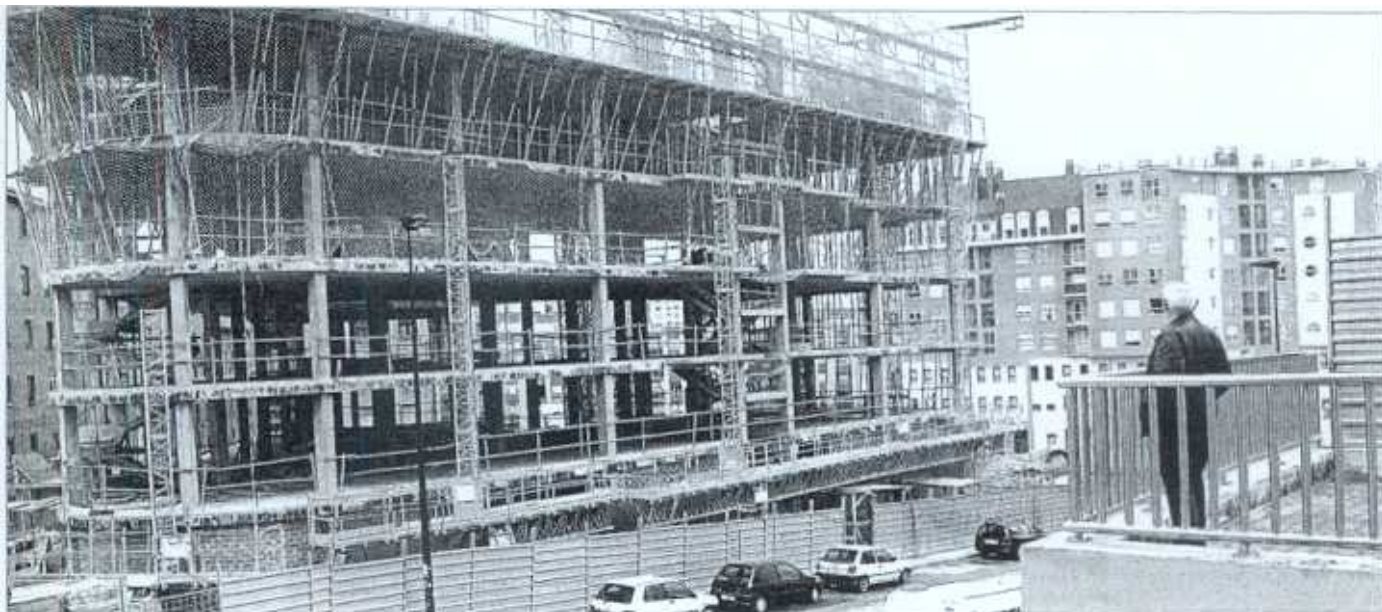
Un hombre observa los trabajos de construcción de un bloque de viviendas de protección oficial en Miribilla. / MITXI
