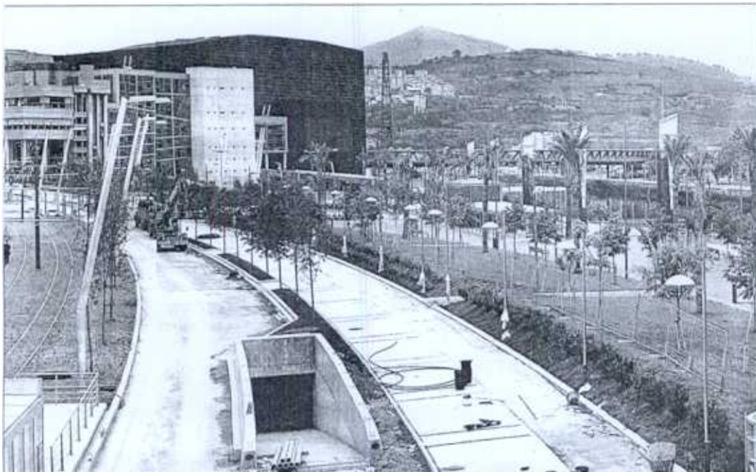
El tramo de la Avenida de Abandoibarra que Bilbao Ría 2000 planea inaugurar a finales de mes presentaba ayer este estado. JIMAI ANDRES
