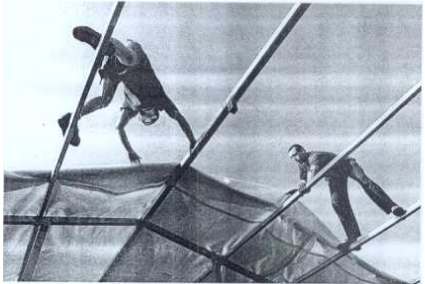
Trabajadores de la construcción realizan una peligrosa tarea de montaje. /EL CORREO
