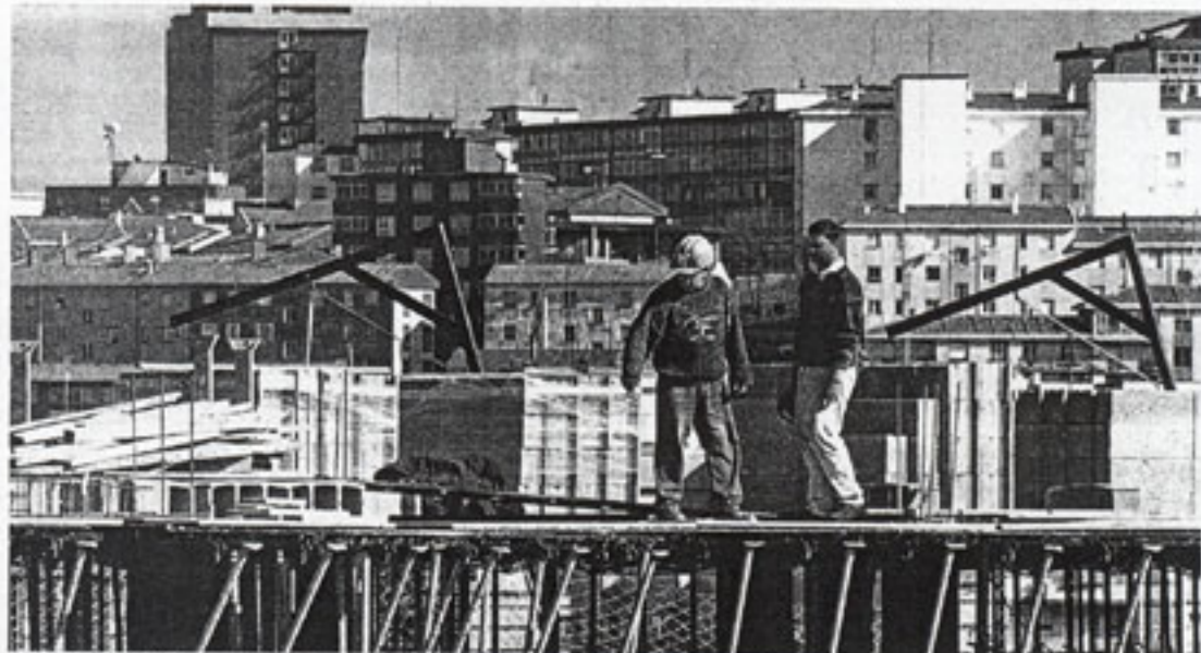
CONSTRUCCIÓN. Obras de una promoción de viviendas en el municipio vizcaíno de Santurtzi. / E. conejo
